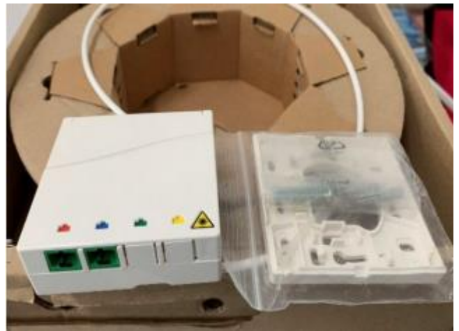
OTO und Gebäudeverkabelung
